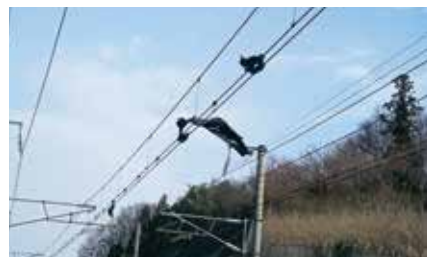
写真 架線に引っかかった農業用ビニール
