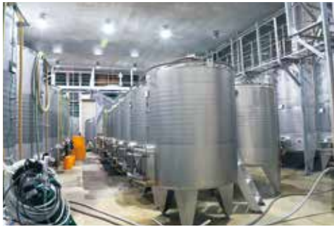
ワインの発酵・熟成に使用するタンク。容量500～10,000ℓのタンクがあわせて50基あります
